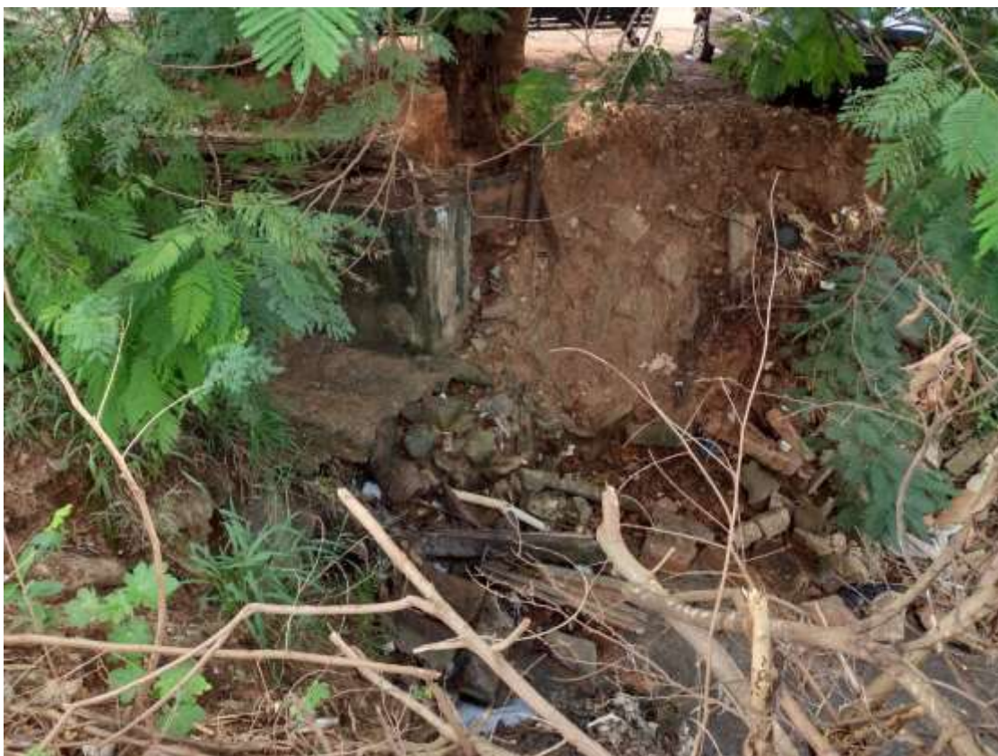
Figura 10. Demonstrativo do processo erosivo.
