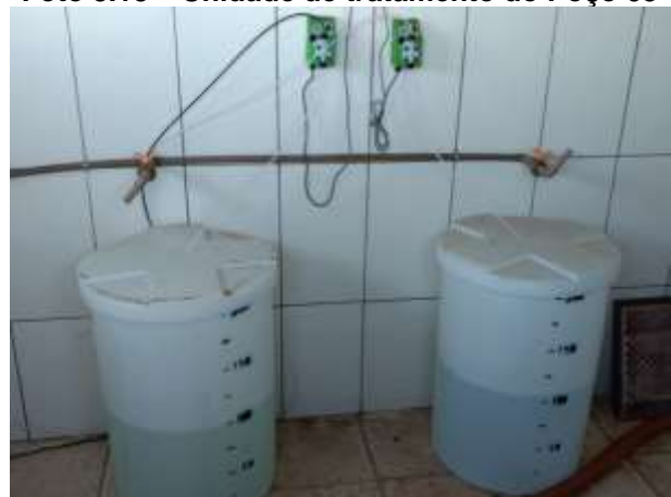
Foto 3.20 – Unidade de tratamento do Poço F.S.
