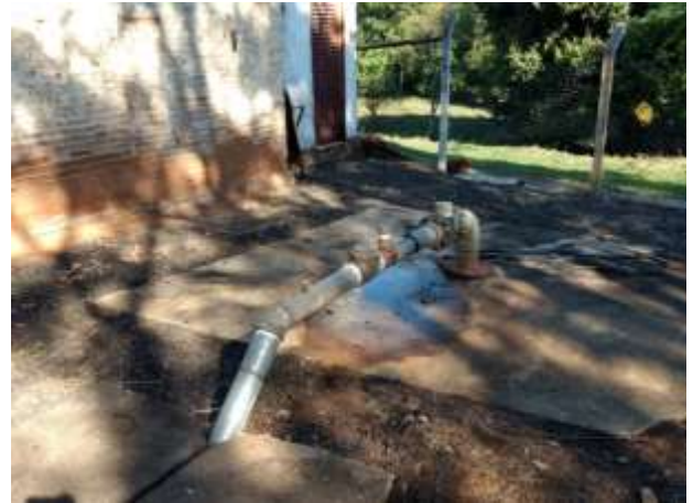
Foto 3.2 - Identificação do Poço: Poço 01
