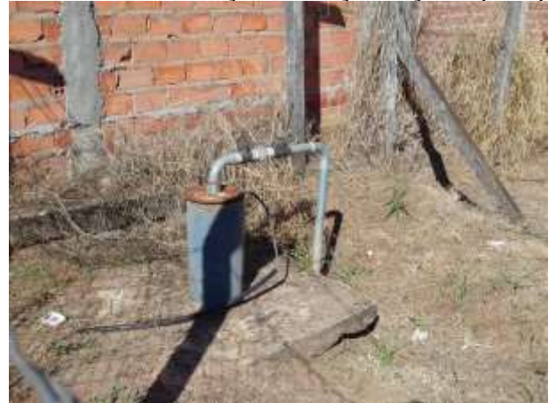
Foto 3.6 - Identificação do Poço: Poço 03 (3)
