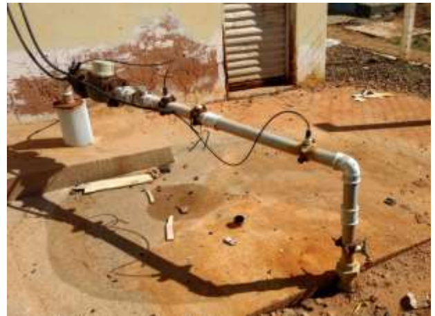
Foto 3.8 - Identificação do Poço: Poço 04
