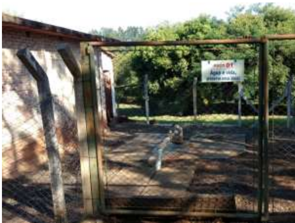
Foto 3.14 – Unidade de tratamento do Poço 01
