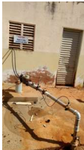
Foto 3.17 - Unidade de tratamento do Poço 04
