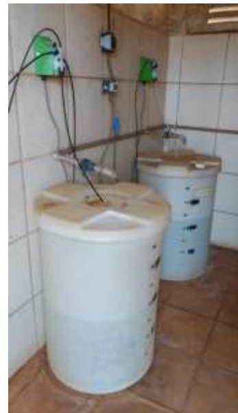
Foto 3.15 - Unidade de tratamento do Poço 02
