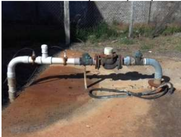
Foto 3.3 - Identificação do Poço: Poço 02
