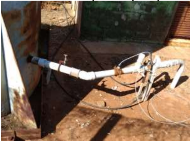
Foto 3.5 - Identificação do Poço: Poço 03 (2)
