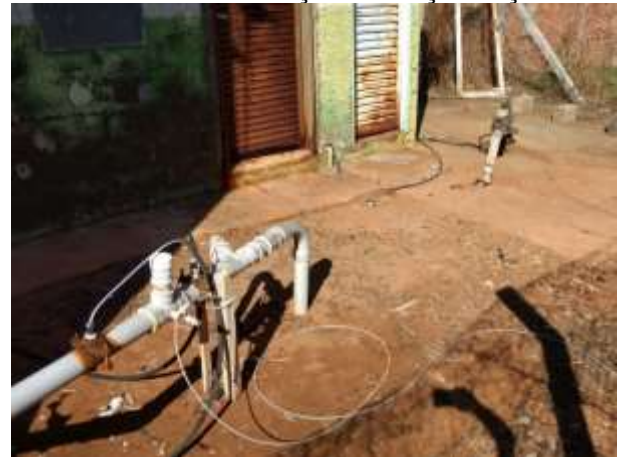
Foto 3.4 - Identificação do Poço: Poço 03 (1 e 2)
