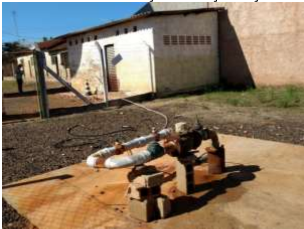
Foto 3.9 - Identificação do Poço: Poço 05
