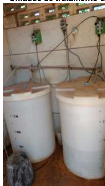
Foto 3.19 - Unidade de tratamento do Poço 06
